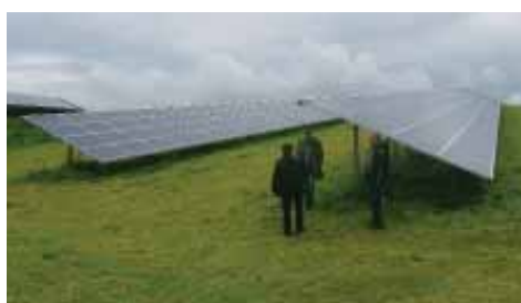
Die Freiflächen PV-Anlage in Bruck/Triftern 13,5 ha
